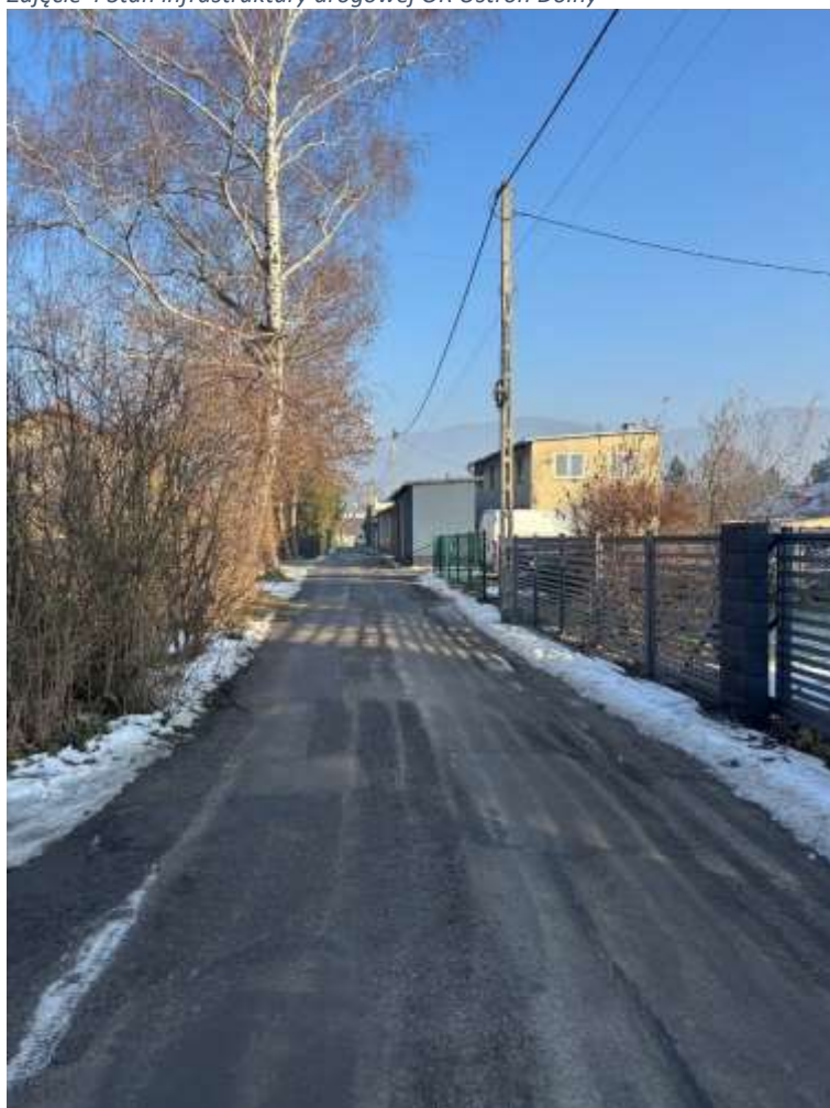
Zdjęcie 4 Stan infrastruktury drogowej OR Ustroń Dolny
